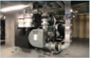
地域冷暖房プラント
